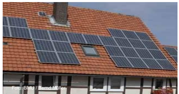
Negativbeispiel: ortsbildschädliche Anordnung der Solarmodule..
